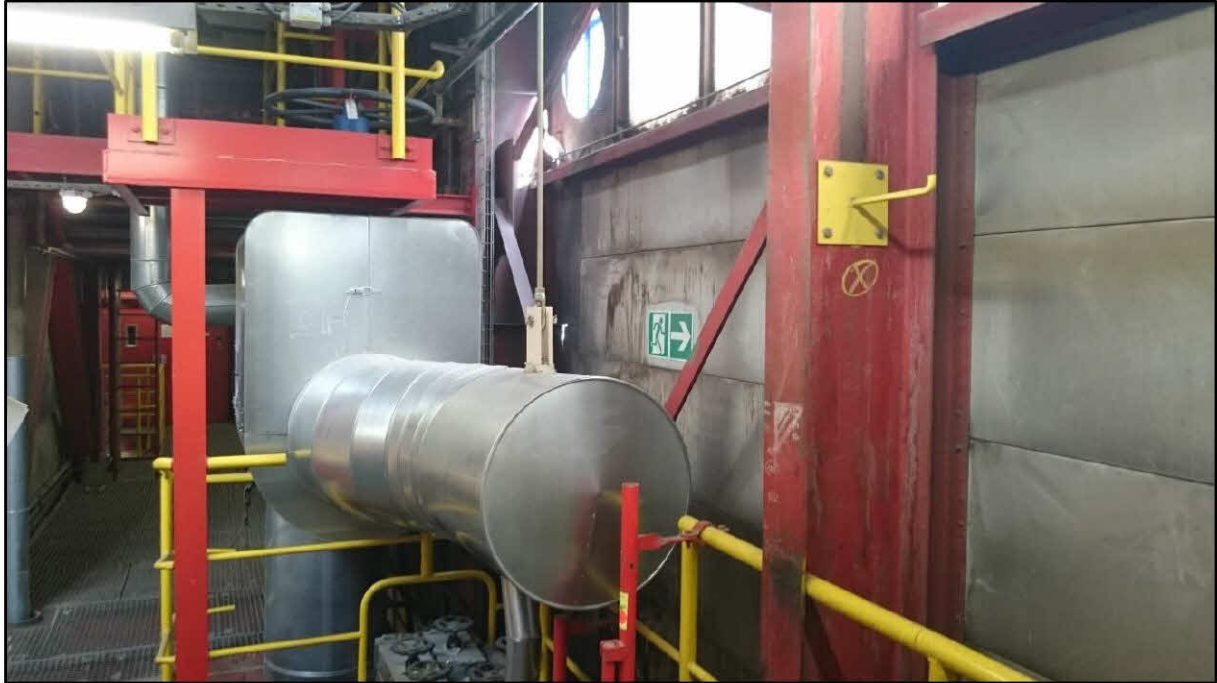
Abbildung 3: Anschlussstutzen am 21 bar-Netz im Kesselhaus der MKVA
